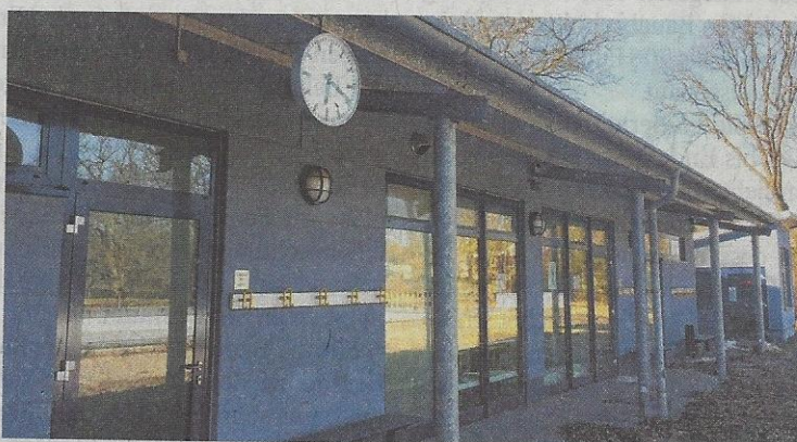
Die Umkleiden wurden 2005 errichtet. Die Uhr steht schon lange.
