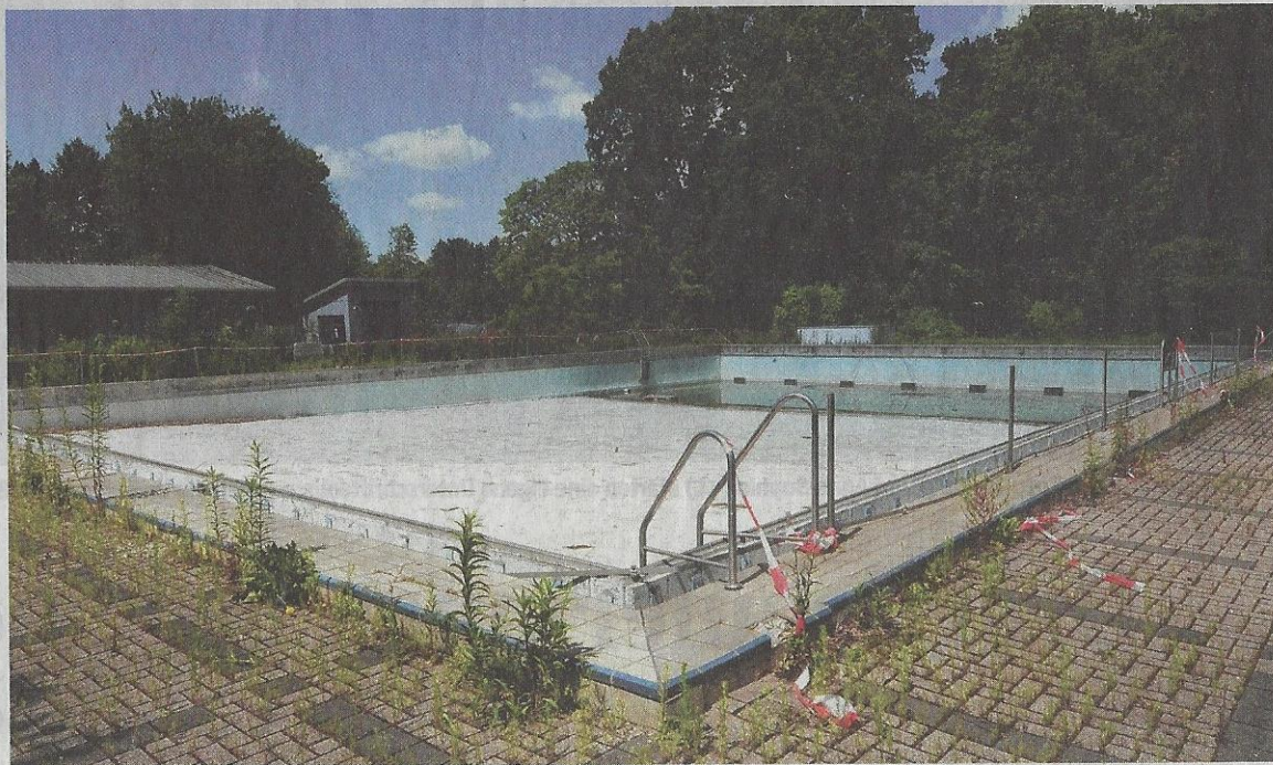
Das Freibad in Hiesfeld wurde 2016 wegen einer defekten Filteranlage außer Betrieb genommen. Danach sollte es saniert werden. Was nun an diesem Standort passiert, ist ungewiss.
